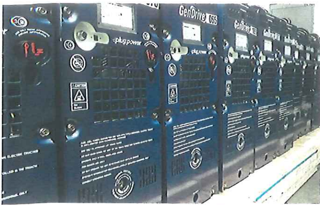
Abb. 3: Gendrive-Module am laufenden Meter, [Quelle: Plug Power]
